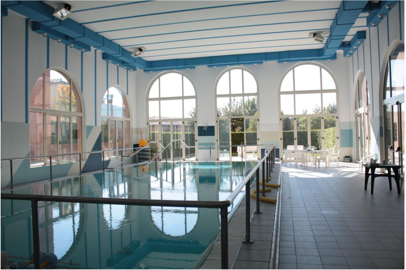
Impianto trattamento aria piscina - Impianto riscaldamento pavimento -
