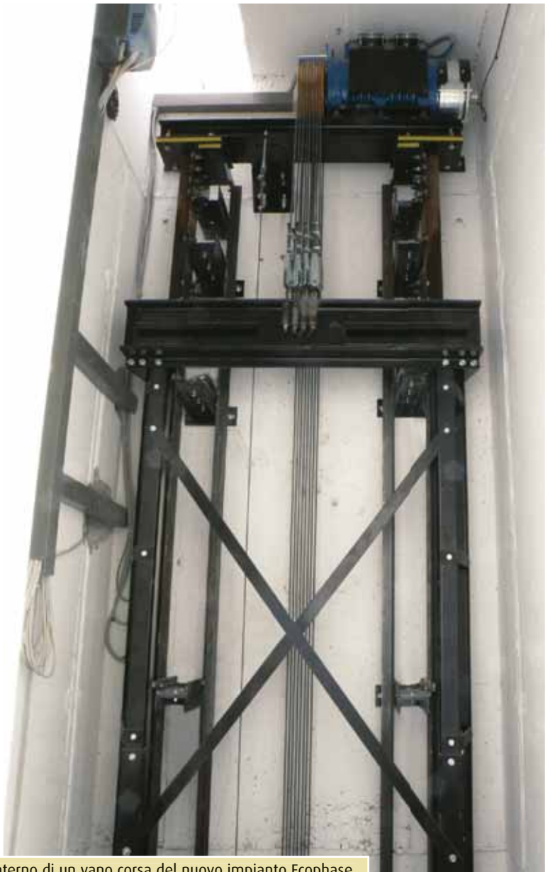
Interno di un vano corsa del nuovo impianto Ecophase, con il motore 220v posto alla sommità.
